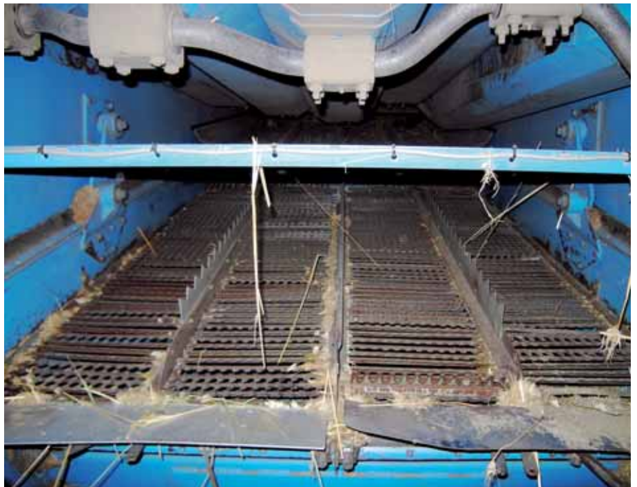
W tych sitach są częściowo wyłamane lamele, co kwalifikuje je do wymiany.
